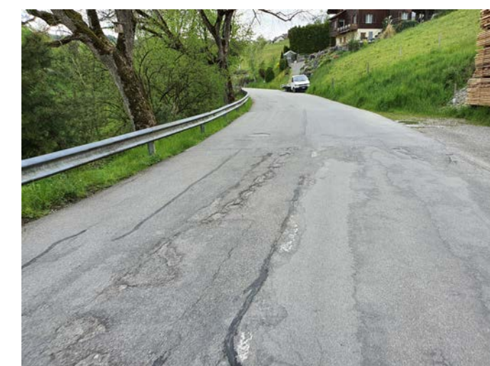
Bild 2: Alte Grabenstrasse mit Belagsschäden
